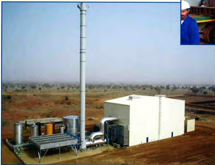
Centrale électrique de Kossodo, Burkina Faso
