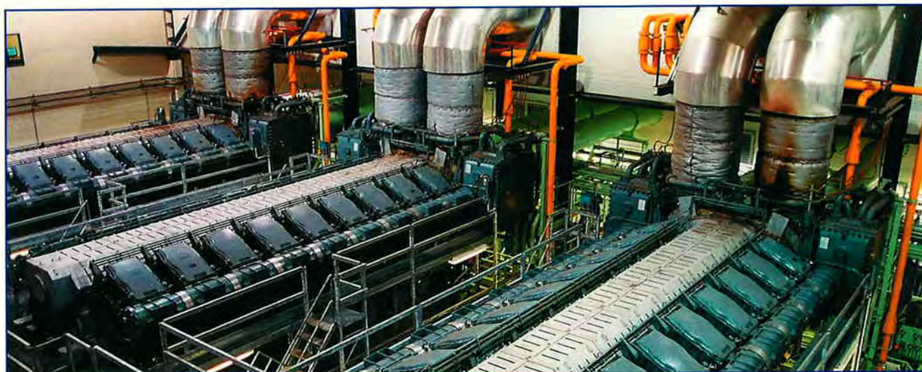
Casa de maquinas
